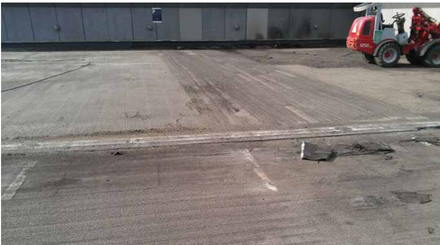
Før fagfolkene fra Decorativa ApS renoverede overfladen med tætningsystemet Triflex ProPark, fjernede de det gamle asfaltlag.
