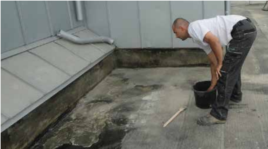
Overfladen på topdækket var flere steder utæt, så regnvand kunne trænge ind i bygningen.
